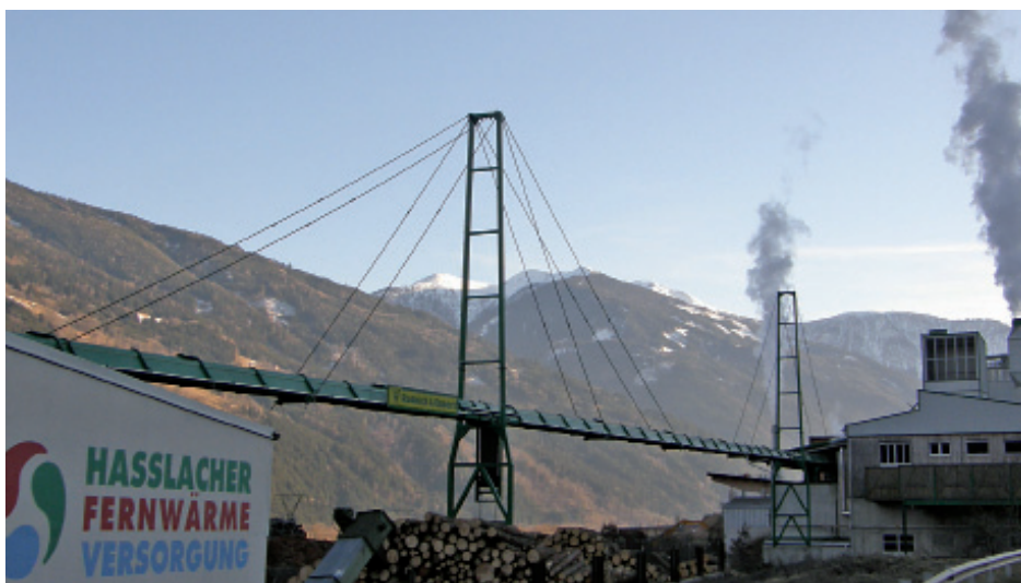
Das Heizkraftwerk der Unternehmensgruppe Hasslacher wird über einen Rudnick & Enners-Rohrgurtförderer beliefert
