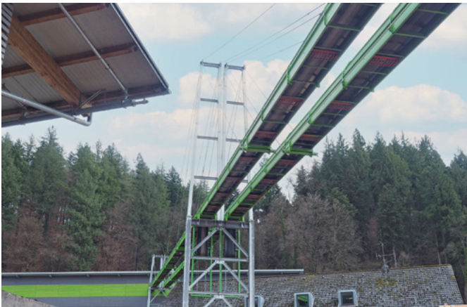
Ein Gurtbecherwerk bringt Sägespäne und Hackgut separat in rund 10 m Höhe zum Rohrgurtförderer, dann wird das Restholz mittels eines Rohrgurtförderers in die Lagerhalle transportiert
