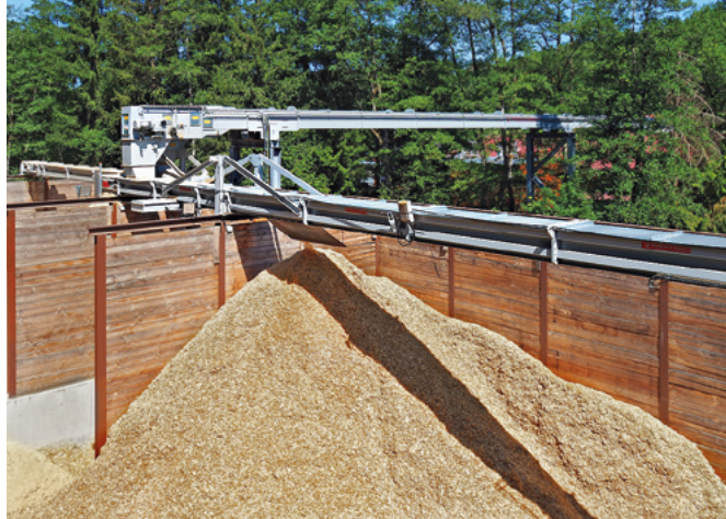
Zwei Rohrgurtförderer bringen Sägespäne und Hackschnitzel getrennt zu den neuen Restholzboxen am Rande des Geländes
