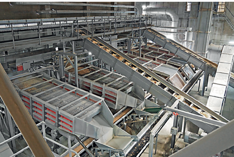
Blick auf die von Rudnick & Enners installierte Sägewerksentsorgung mit den Siebmaschinen
