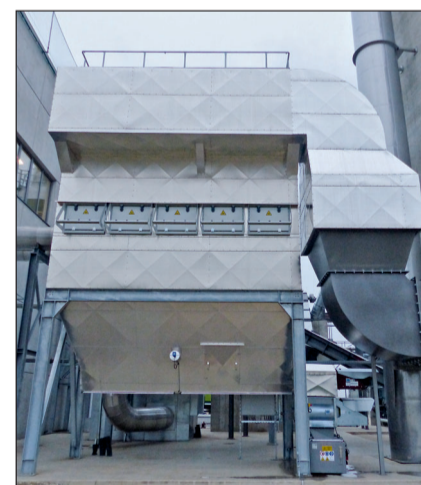
Die Absaugung in der Pelletproduktion und der Verladestation stammt von Scheuch Ligno.
