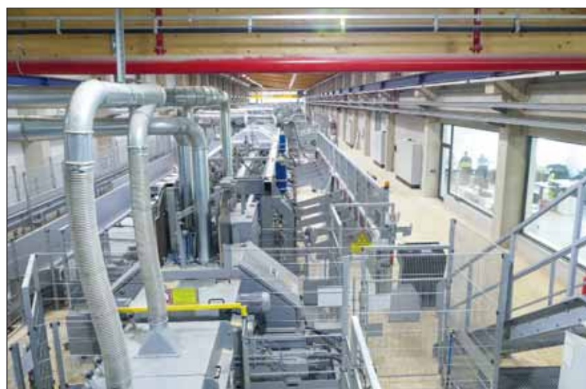
Blick vom Ende der Spanner- und Profilierlinie her in die Sägehalle: Rechts der zentrale Leitstand für sämtliche Anlagen bis hin zu Sortierung und Paketierung.
