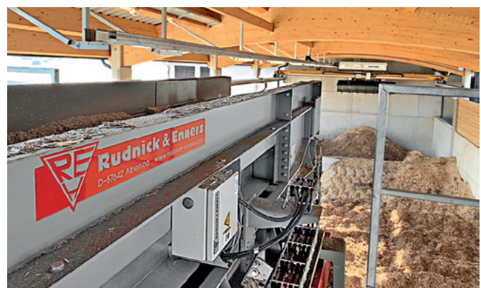
Kontrollierte Zuführung des homogenen Materials zum Heizwerk – entweder in die Beschickungsbox des Krans oder automatisch in eine Vorbox
