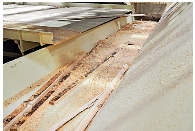
Aufgrund des neu gedachten Konzepts im Bereich der Restholzensorgung kommt man mit deutlich kürzeren Förderwegen aus
