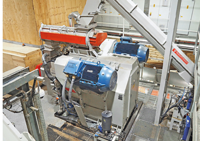
Zwei jeweils 280 kW starke Motoren sorgen bei der PM7-Pressen für eine Leistung von 7 bis 8 t/h
