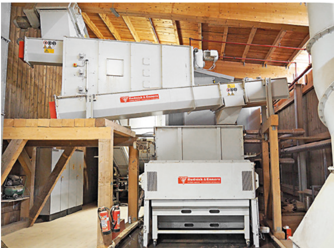
Vor zwei Jahren hinzugekommen: der zweite Bandtrockner von Rudnick & Enners inklusive einer Wärmerückgewinnung
