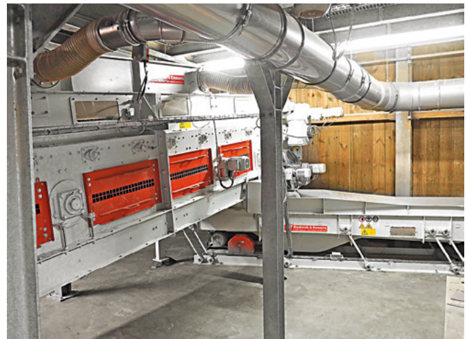
Im Horizontalkühler von Rudnick & Enners haben die Pellets Zeit abzukühlen. Danach geht es rechts in die Siebrinne, um den Staub herauszufiltern
